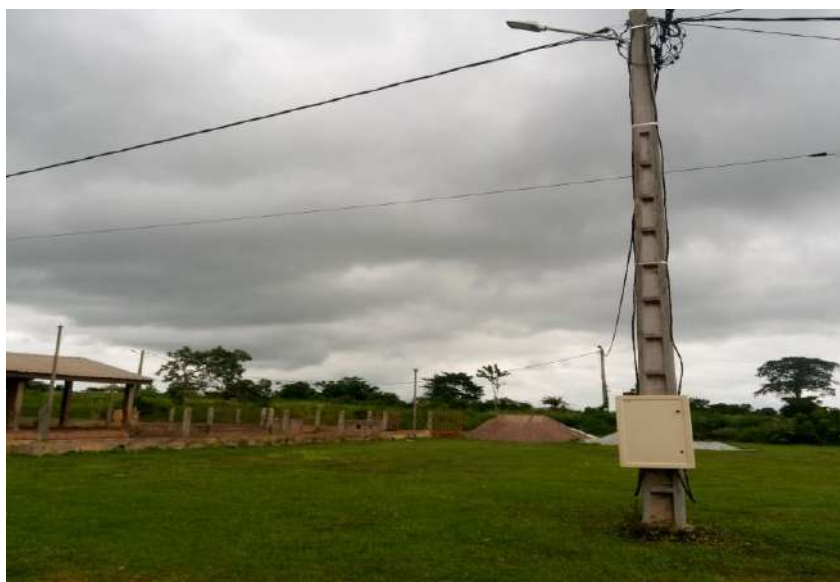
Figure 16: Vue du réseau électrique
