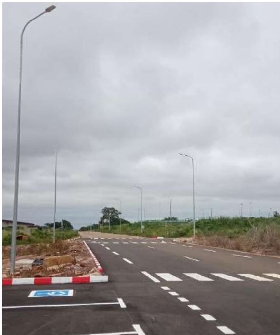
Figure 11: Vue du système d'éclairage à l'UJLOG
